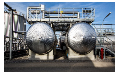
В последние годы Wintershall инвестировала в модернизацию оборудования.
