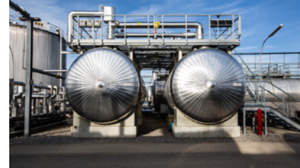
Wintershall hat in den letzten Jahren in die Modernisierung von Anlagen investiert.
