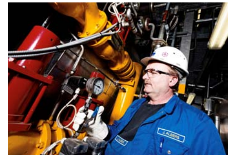
Stabile Förderung dank anspruchsvoller Technik: Seit 1981 setzt Wintershall in Emlichheim auf das Dampfpluten.
